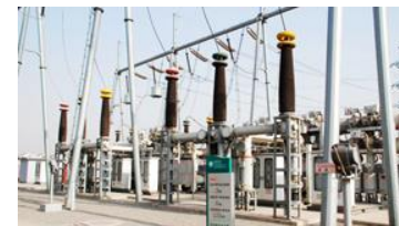
变电站无人值守监控
