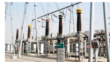
变电站无人值守监控
