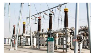
变电站无人值守监控
