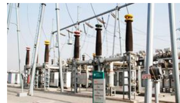
变电站无人值守监控
