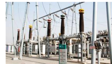
变电站无人值守监控
