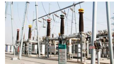
变电站无人值守监控
