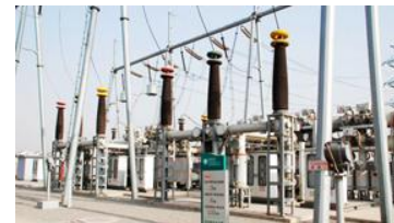
变电站无人值守监控
