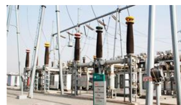
变电站无人值守监控
