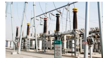
变电站无人值守监控
