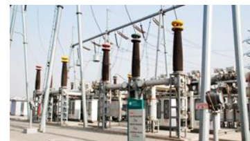
变电站无人值守监控
