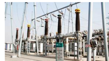
变电站无人值守监控
