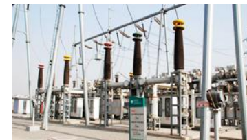
变电站无人值守监控
